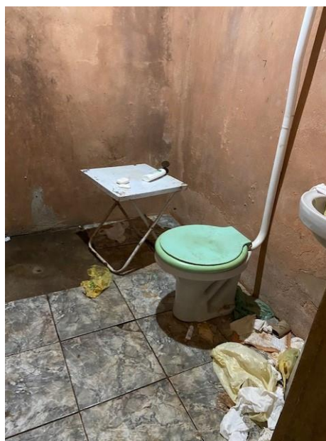
Banheiro sem adaptação
